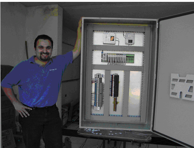
Gabinete de control
