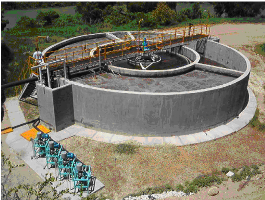
Planta de Tratamiento de Aguas Soto la Marina, Tamaulipas, México Capacidad 15 LPM
