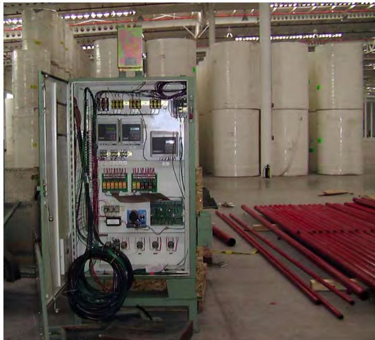
Equipo de control con acumulador de logs original (equipo Opto 22 primera generación).
